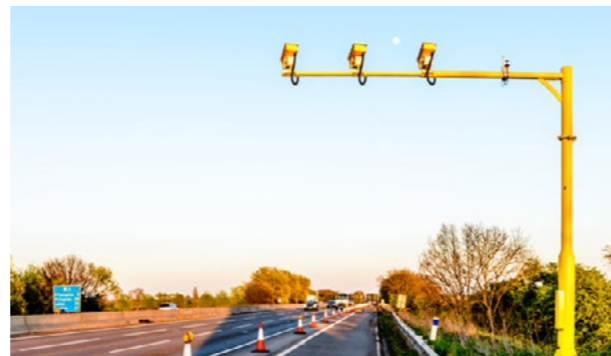
Hình ảnh Hệ thống camera tại điểm bản tốc độ
